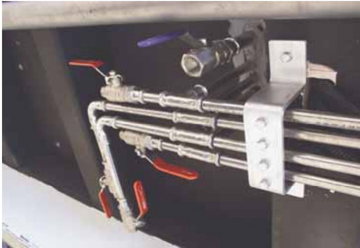
Abbildung 8: Entwässerungsventile unter dem Durchlauferhitzer (hier: alle geöffnet) [Wenking, IdF NRW]
