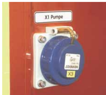
Abbildung 17: Steckdose Stromversorgung Abwasserpumpe [Wenking, IdF NRW]
