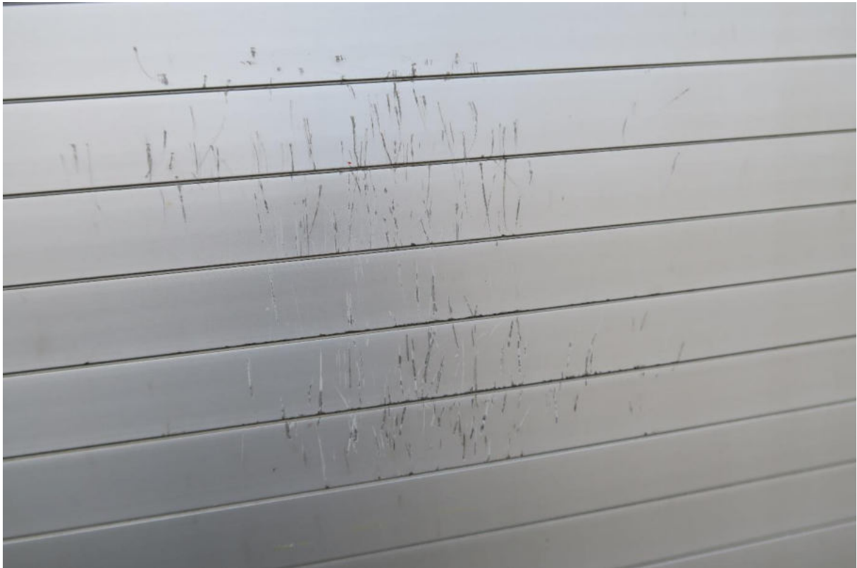
Foto 51: Lamellenverschluss Geräteraum 1 verkratzt
