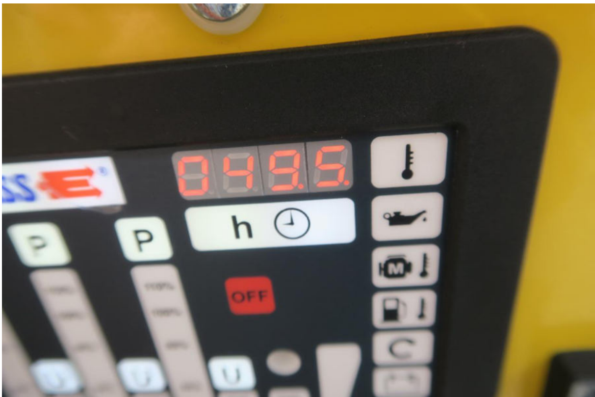
Foto 32: Ansicht Betriebsstunden tragbarer Stromerzeuger
