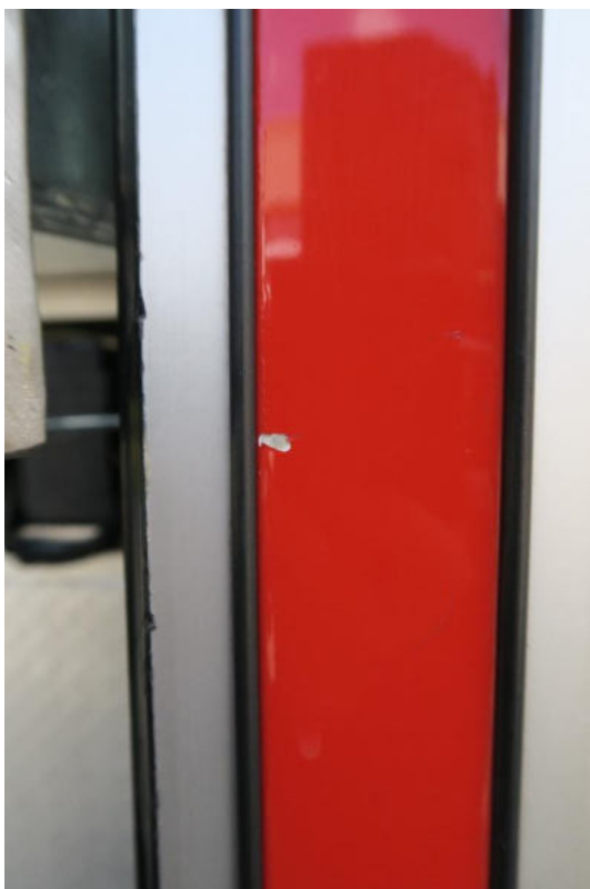
Foto 48: Lackschäden Geräteraum Aufbau
