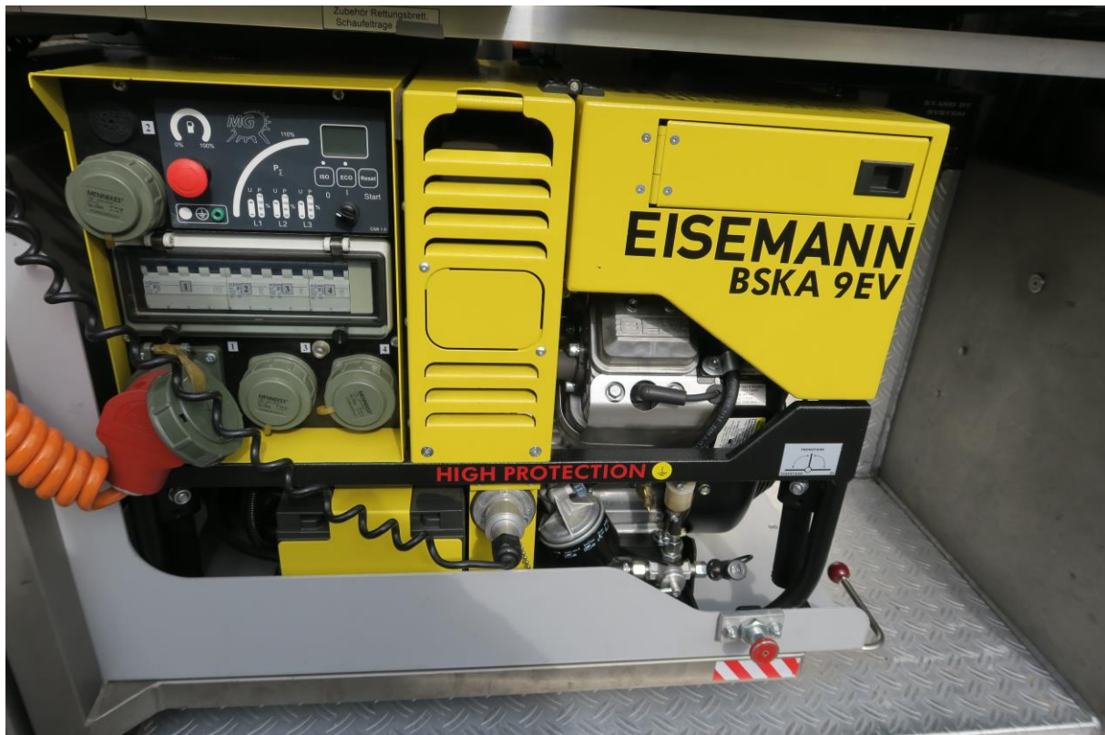
Foto 33: Stromerzeuge auf Drehgestell
