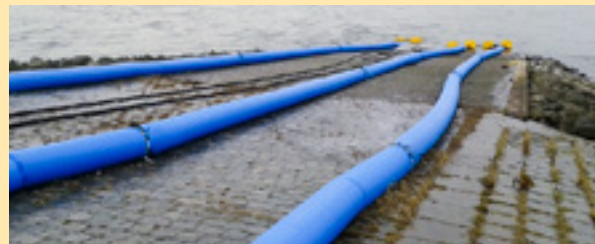
Flood Modules im Einsatz
